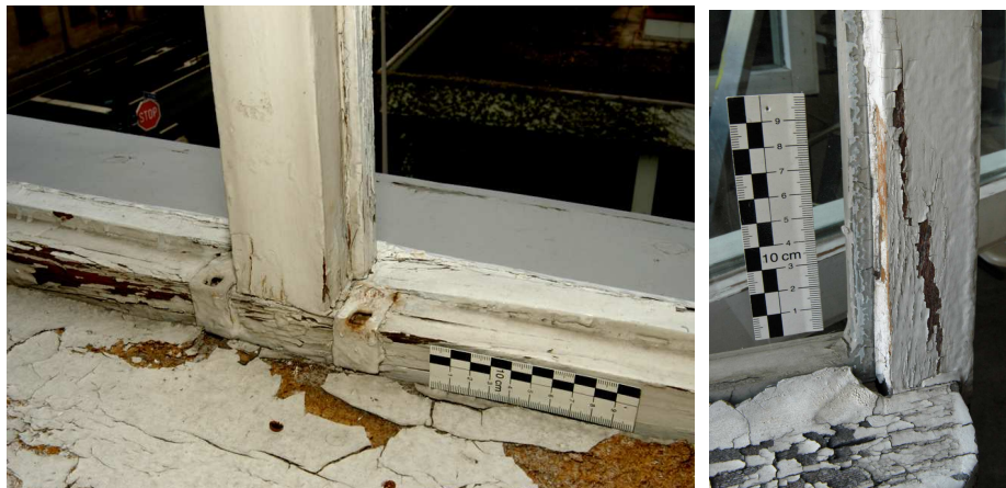
Detailaufnahmen der maroden Stock- und Flügelrahmen historischer Fenster
