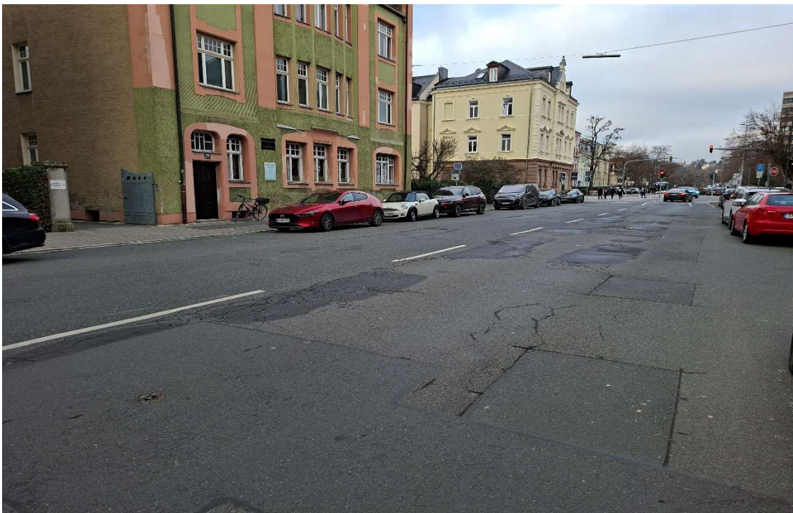
Unebenheiten, Risse und Flickstellen
