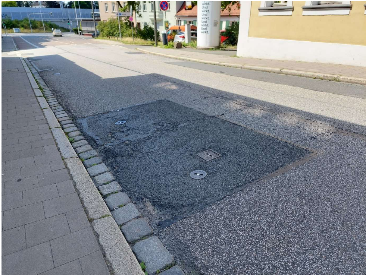
Ausmagerungen und Risse
