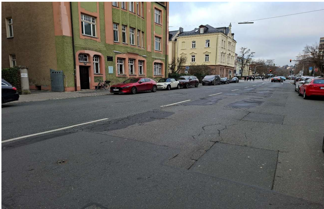
Unebenheiten, Risse und Flickstellen
