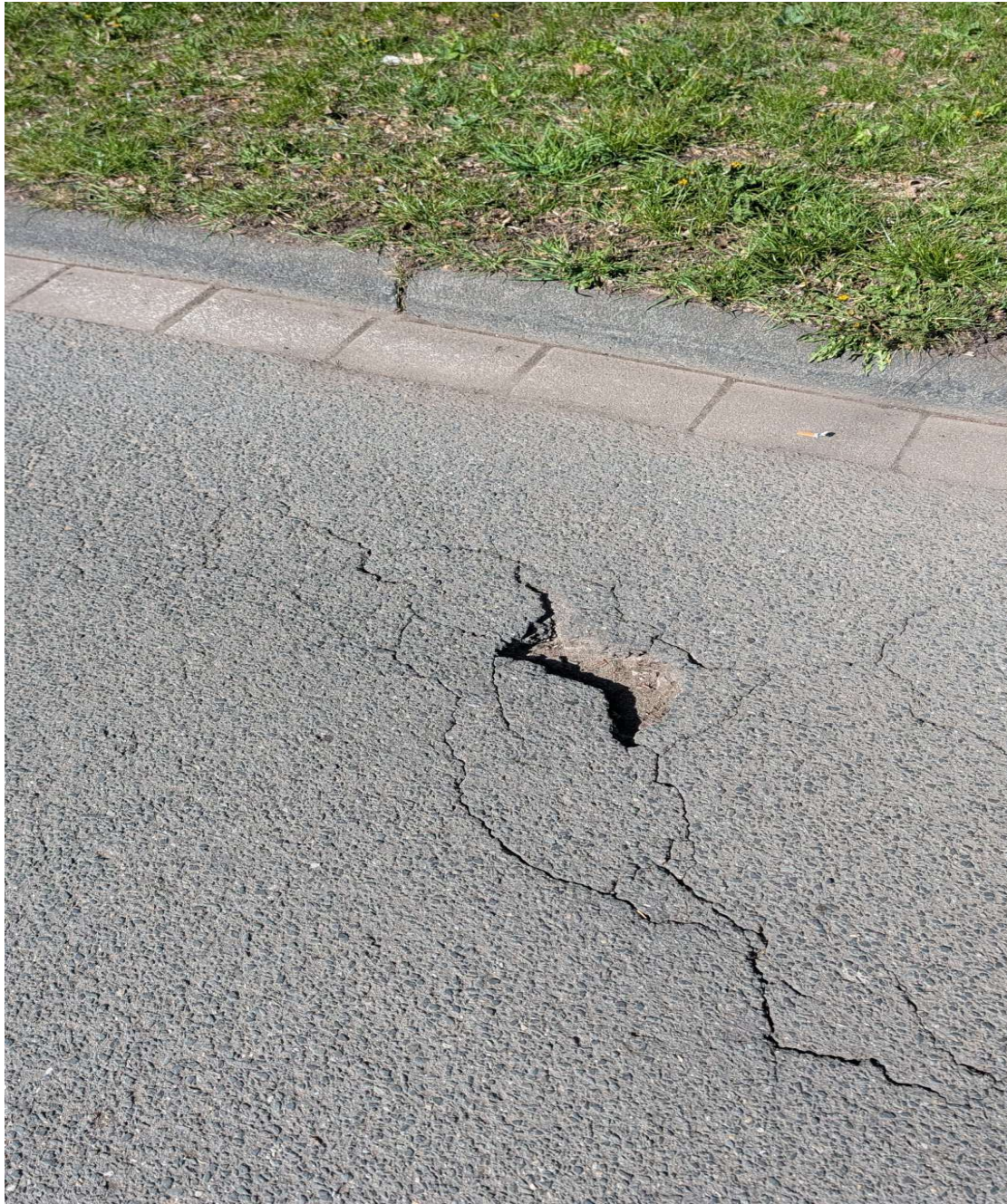
Schlagloch und Netzzrisse
