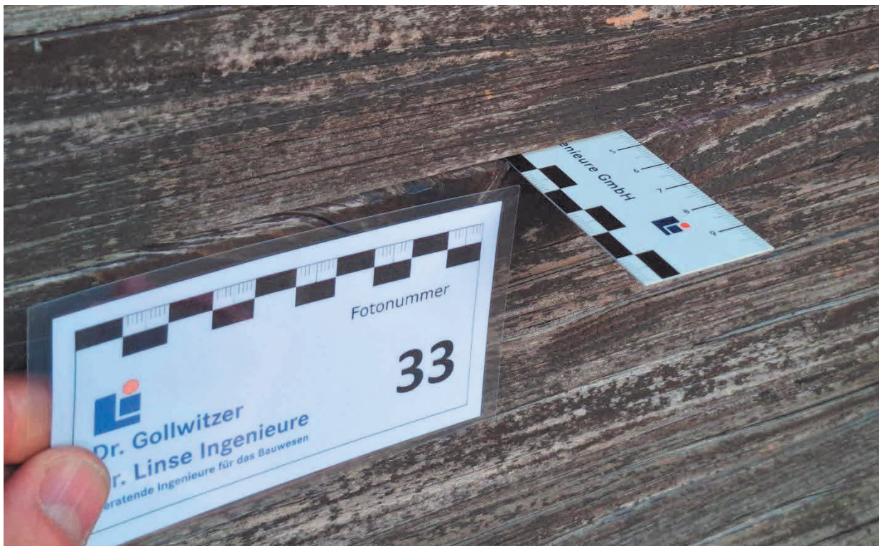
Abbildung 6 beispielhafte Abbildung eines markanten Risses mit 4,5cm Tiefe
