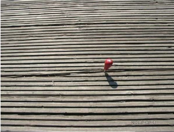
Kernfäule im Rissbereich
