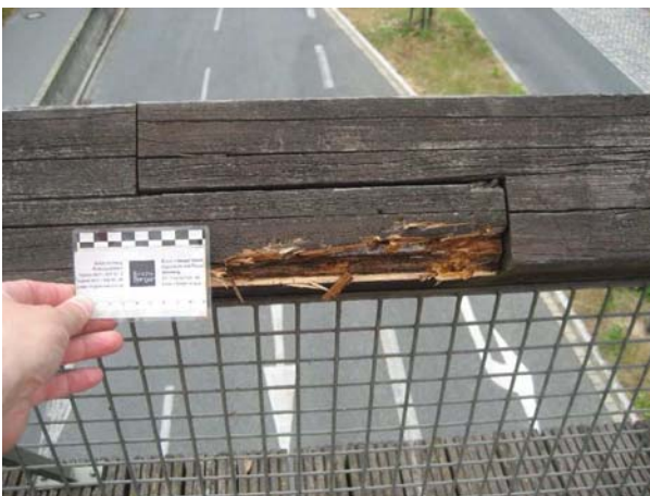
Handlauf in Auflösung
