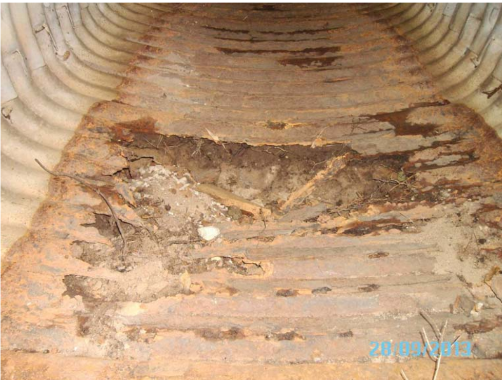
Sohle der Wandung Wellstahlprofil durchgerostet, Lochfraß. Gefahr der Ausspülung und daraus möglich folgender Straßeneinbruch. Durchlassüberdeckung nur 17 cm bis Straßenoberkante.
