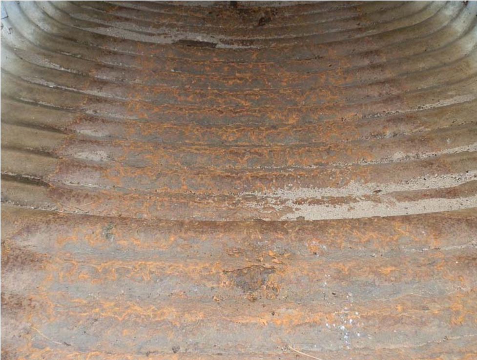
Sohle der Wandung durchgehend rostend.
