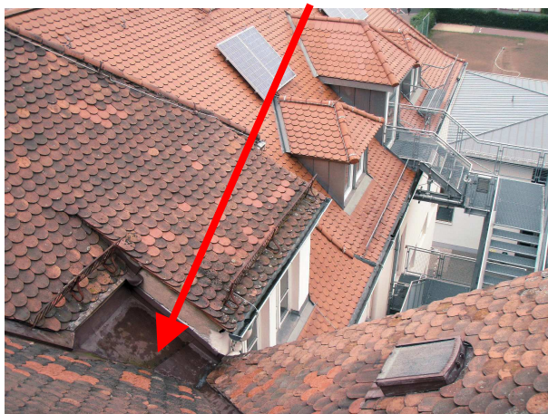
Dachverschneidungen, nicht kontrollierbarer Zusammen- und Abfluss des Regenwassers
