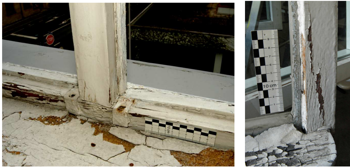
Detailaufnahmen der maroden Stock- und Flügelrahmen historischer Fenster
