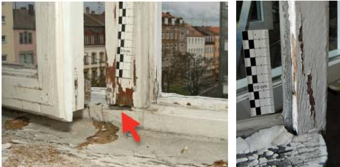
Abb. 2: Fotos der Schadenskartierung von Restauratoren eines Klassenraumfensters der Westseite
